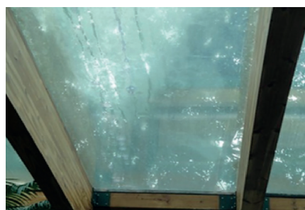
Illustration 12 : dégradation de vitrage isolant.
