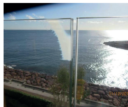
Illustration 16 : dégradation de l'intercalaire du verre feuilleté assurant la fonction de garde-corps.
